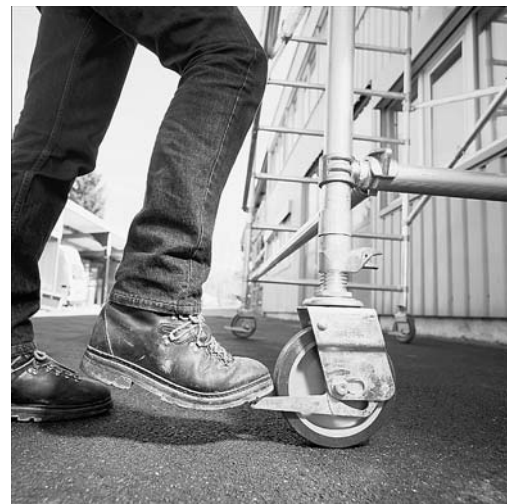
Fig. 4: seules des roues bloquées évitent un déplacement involontaire de l'échafaudage roulant.
